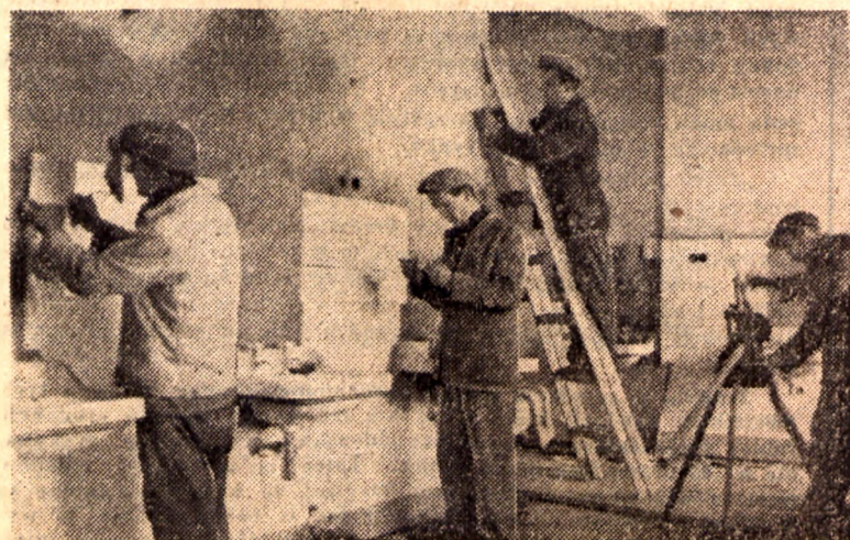
Wzorcowy zakład fryzjerski, mieszczący się przy ul. Krak. Przedm. 50 po gruntownym remoncie będzie nowoczesnie urządzone. Robotnicy Rzemieślniczej Spółdzielni Budowlanej, zobowiązali się wykonać wszystkie prace do dnia 20 bm.
