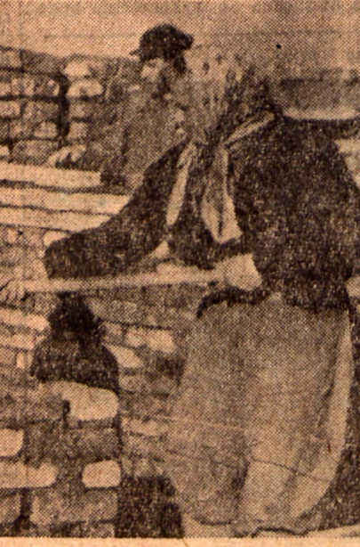
Na terenie budowy osiedla mieszkaniowego — Warszawa — Koło pracują między innymi dwie przodujące murarki, Józefa Tratkiewicz i Halina Ber. Wykonują one przeciętnie 300% normy. Na zdjęciu: Halina Ber i Józefa Tratkiewicz przy pracy. (CAF — fot. Szyperko)
