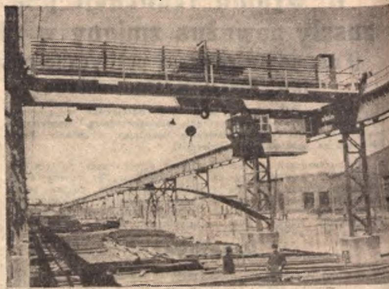
Tempo prac przy budowie Nowej Huty znacznie wzrosło. Robotnicy podejmują liczne zobowiązania przedterminowego ukończenia wyznaczonych robót. Na zdjęciu: fragment wykończonej estakady.
