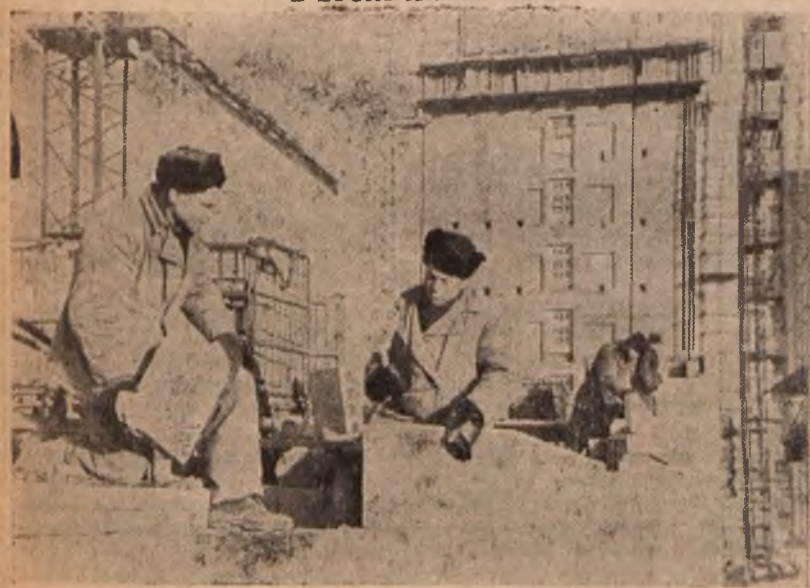
W Moskwie na Wybrzeżu Drogomilowskim znajduje się w budowie 32-piętrowy hotel. Na zdjęciu: oblicowywanie gmachu na 14-tym piętrze blokami ceramicznymi. (Fot — CAF)
