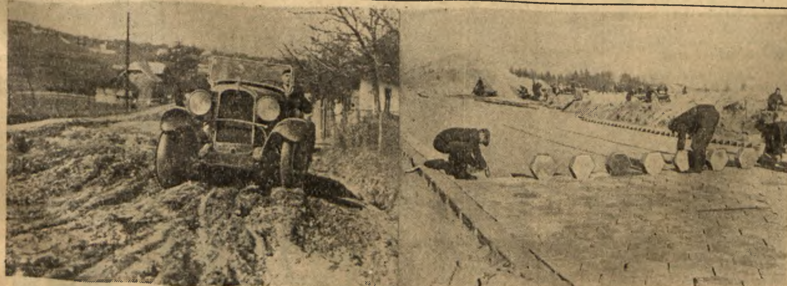
DROGI W POLSCE PRZEDWROZESNIOWEJ (NA ZDJĘCIU Z LEWEJ STRONY) PRZEDSTAWIAŁY OBRAZ ZANIEDBANIA I RUINY. NIKIE INWESTYCJE NA TYM ODCINKU I BRAK KONSERWACJI SPOWODOWAŁY, ŻE WIELE WYSILKU I KOSZTÓW TRZEBA OBECNIE PONOSIĆ, ABY STAN TEN NAPRAWIĆ. POLSKA LUDOWA BUDUJE INNE DROGI (NA ZDJĘCIU Z PRAWEJ STRONY) — SZEROKIE, O DOBREJ NAWIERZCHNI
