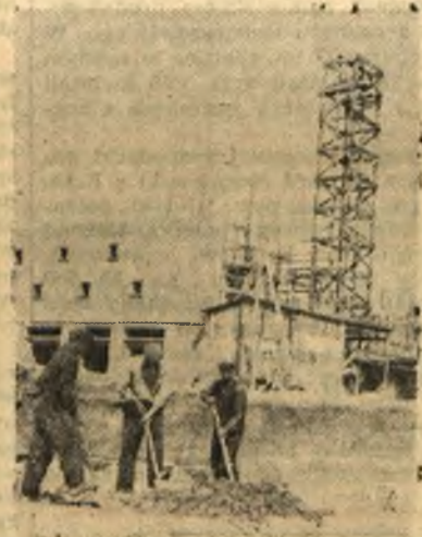
Bodaczów. Przy wykopach na budowie kombinatu pracują okoliczni chłopcy — Fr. Bielec, Br. Szeliaga i Edward Popielec, wysuwając się na czoło przodowników pracy.
