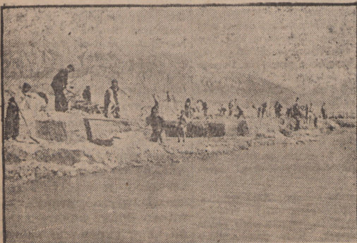
Budowa kanału Maliq w Albanii, jedna z największych robót inwestycyjnych prowadzonych obecnie w Albanii.
