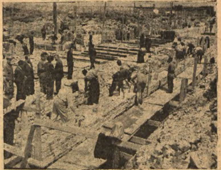
Technicy budowlani PPB w osiedlu Muranów podjęli 2-godzinną próbę pracy murarskiej. Próba się powiodła, zespół pięciorobowy w ciągu 2-ch godzin ułożył 3.000 cegieł. Na zdjęciu — dwa zespoły techników przy pracy
